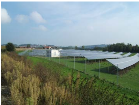
Abb 5. Beispiel Freiflächenfotovoltaikanlage Reitern
